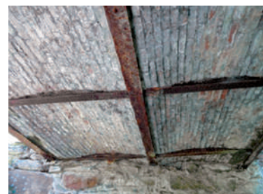
Oxydation de la structure et efflorescences généralisées
